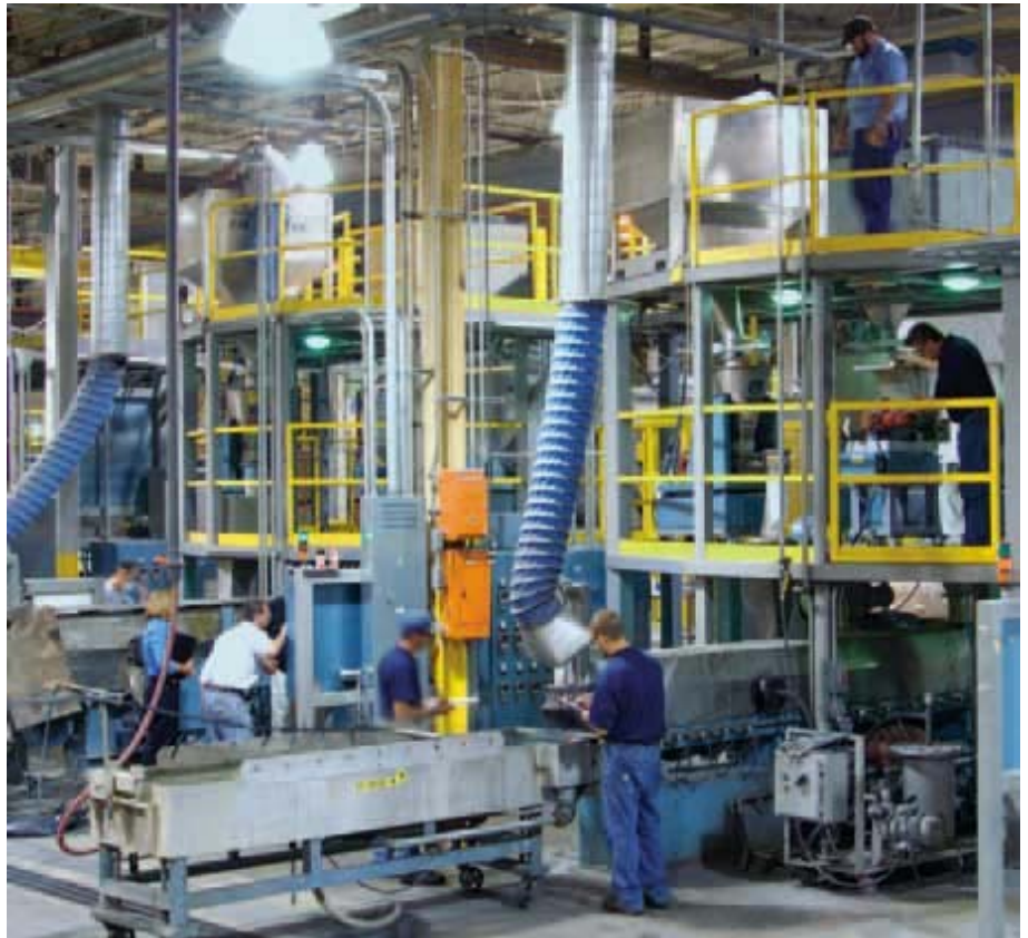
Los ingredientes son descargados por gravedad desde tolvas portátiles que se encuentran elevadas sobre dosificadores pérdida-de-peso.
