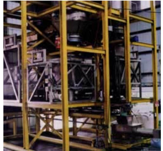
Las 5 tolvas de plataforma de 5-toneladas alimentan materiales crudos a los dosificadores Loss-in-Weight. Cada uno de las mini-tolvas tiene un activador y una válvula de compuerta con cuchillas de 12 pulgadas. Un mezclador de 20 pies se vacía hacia otro mezclador horizontal.
