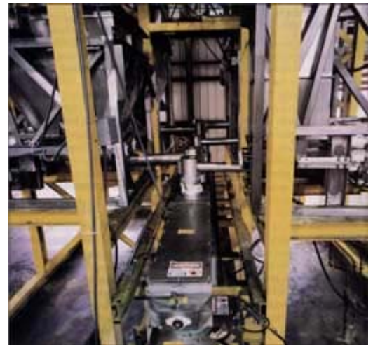
5 dosificadores Loss-in-Weight miden materiales crudos a un mezclador continuo, proveyendo una composición de producto constante para empaçar.
